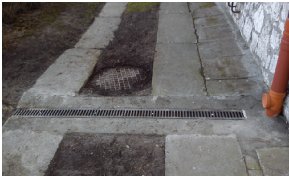
Odprowadzenie wód deszczowych z okolicy budynku (fot. M. Siudak)
