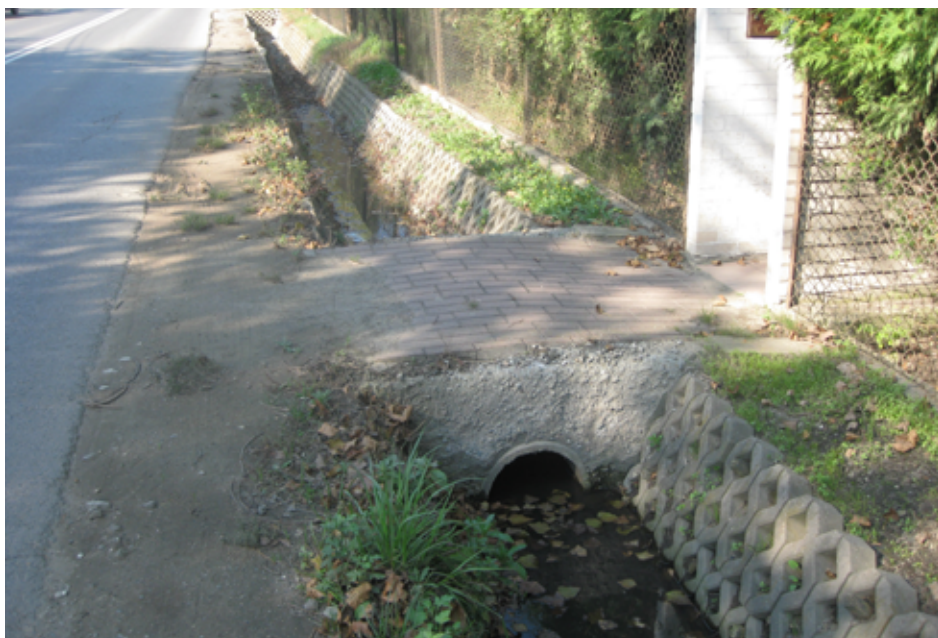
Prawidłowo utrzymany rów odwadniający (fot. M. Siudak)
